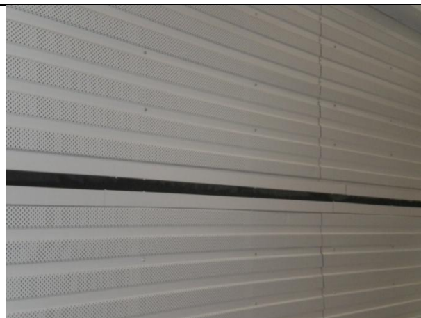
Elementerne fra undersiden. Samlingen mellem elementerne ses som en bred fuge. Det er ikke muligt at konstatere om dampspærren er samlet tæt.
