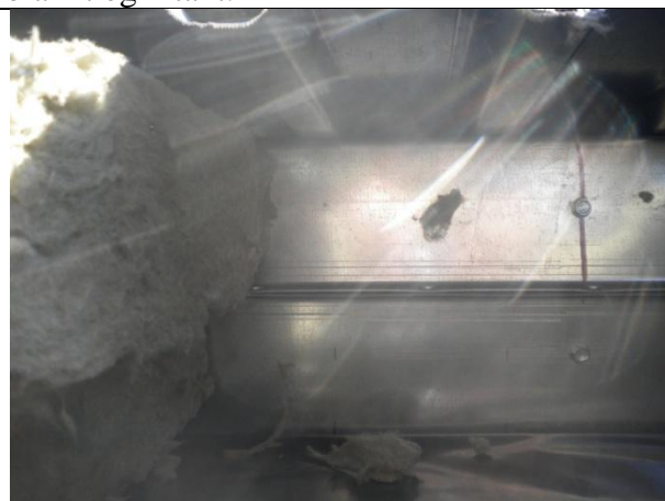
Bjælke og isolering i elementet. Der kunne ikke konstateres fugt eller tegn på tidligere opfugtning.
